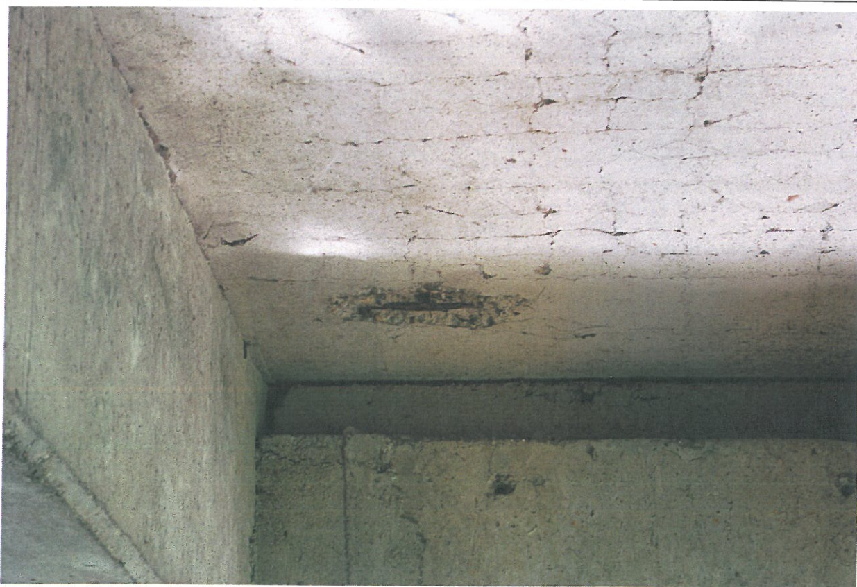
Fot. 16. Ubytki i korozja betonu, korozja odsłoniętych prętów zbrojeniowych oraz zarysowania płyty pomostu
