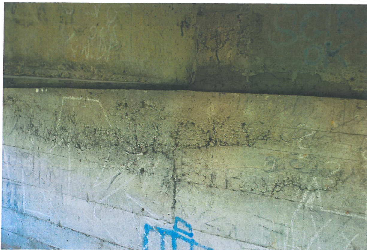
Fot. 22. Zanieczyszczenia i raki przyczołka – widok od strony południowej.
