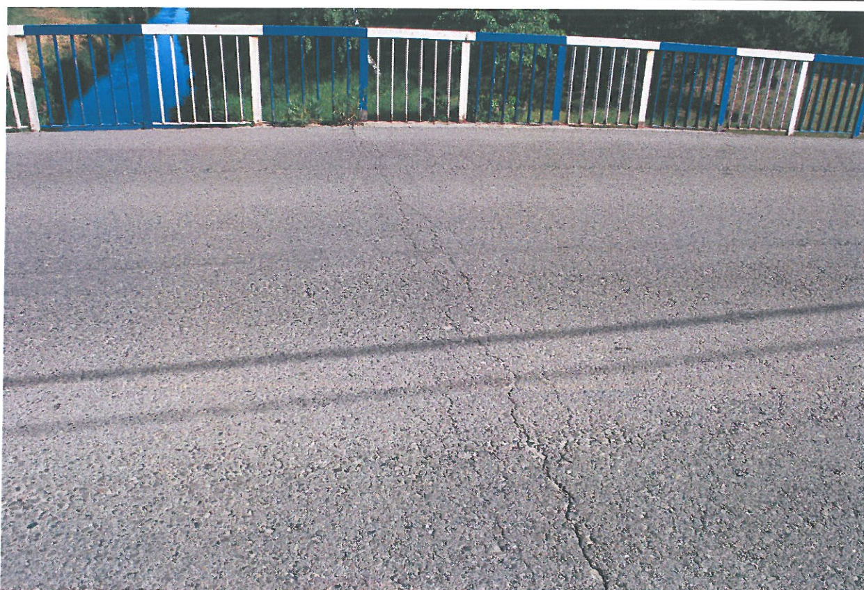
Fot. 10. Rysy i wykruszenia nawierzchni jezdni nad podporą nr 2.
