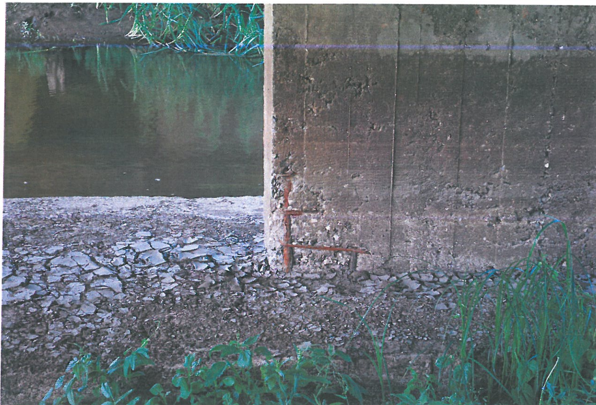
Fot. 23. Ubytki betonu, korozja betonu, korozja odsłoniętych prętów zbrojeniowych filara podpory nr 1.
