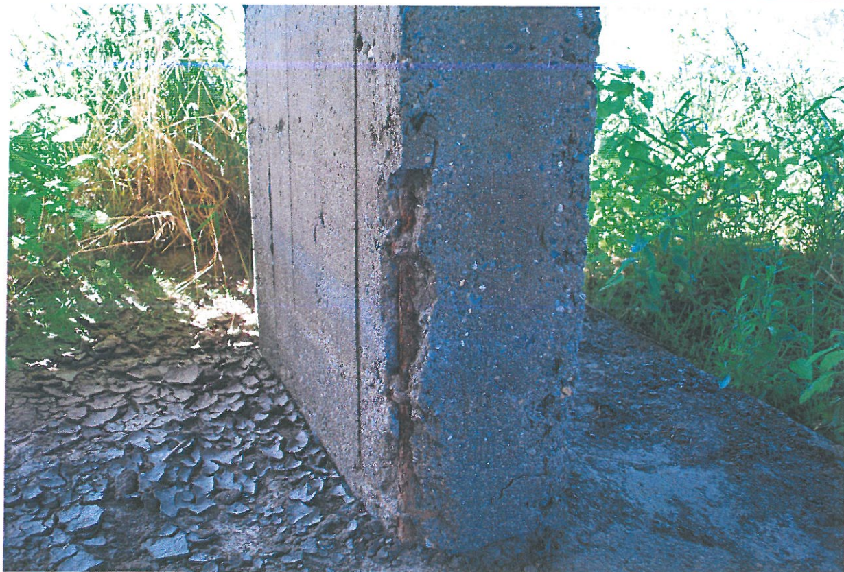
Fot. 25. Ubytki betonu, korozja betonu, korozja odsłoniętych prętów zbrojeniowych filara podpory nr 2.
