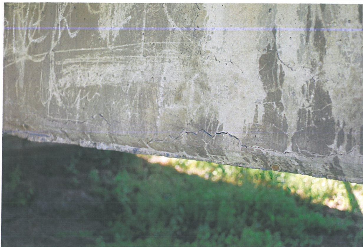
Fot. 19. Odspojenie betonu prefabrykowanego dźwigara.
