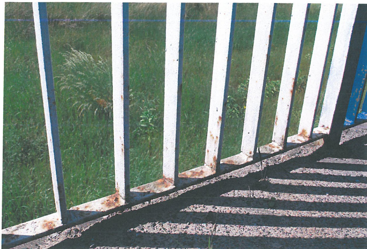
Fot. 11. Korozja balustrady spowodowana brakiem systematycznych prac utrzymaniowych.
