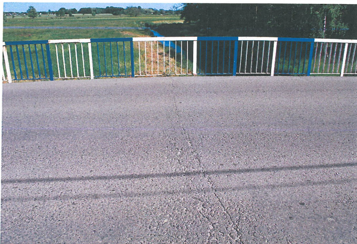
Fot. 9. Rysy i wykruszenia nawierzchni jezdni nad podporą nr 1.
