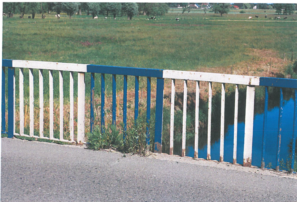
Fot. 12. Korozja balustrady i wegetacja roślin spowodowana brakiem systematycznych prac utrzymaniowych.
