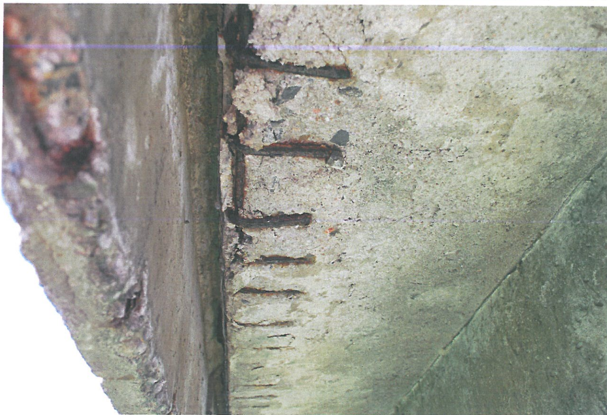
Fot. 17. Ubytki betonu, korozja betonu, korozja odsłoniętych prętów zbrojeniowych wspornika płyty pomostu.
