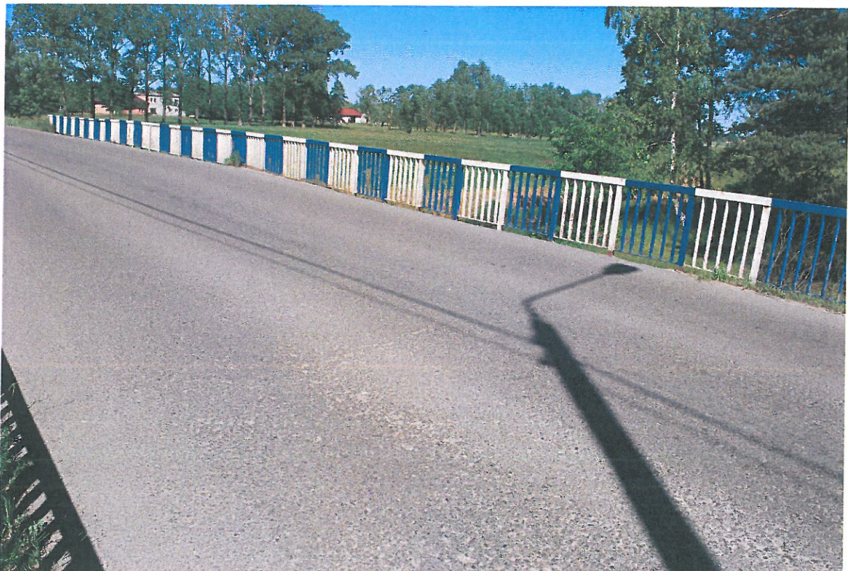
Fot. 8. Rysy i wykruszenia w nawierzchni jezdni na dojeździe od strony południowej.
