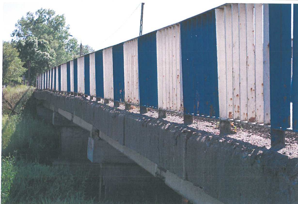
Fot. 14. Deformacja i zanieczyszczenia prefabrykowanego gzymsu (kapy chodnikowej).
