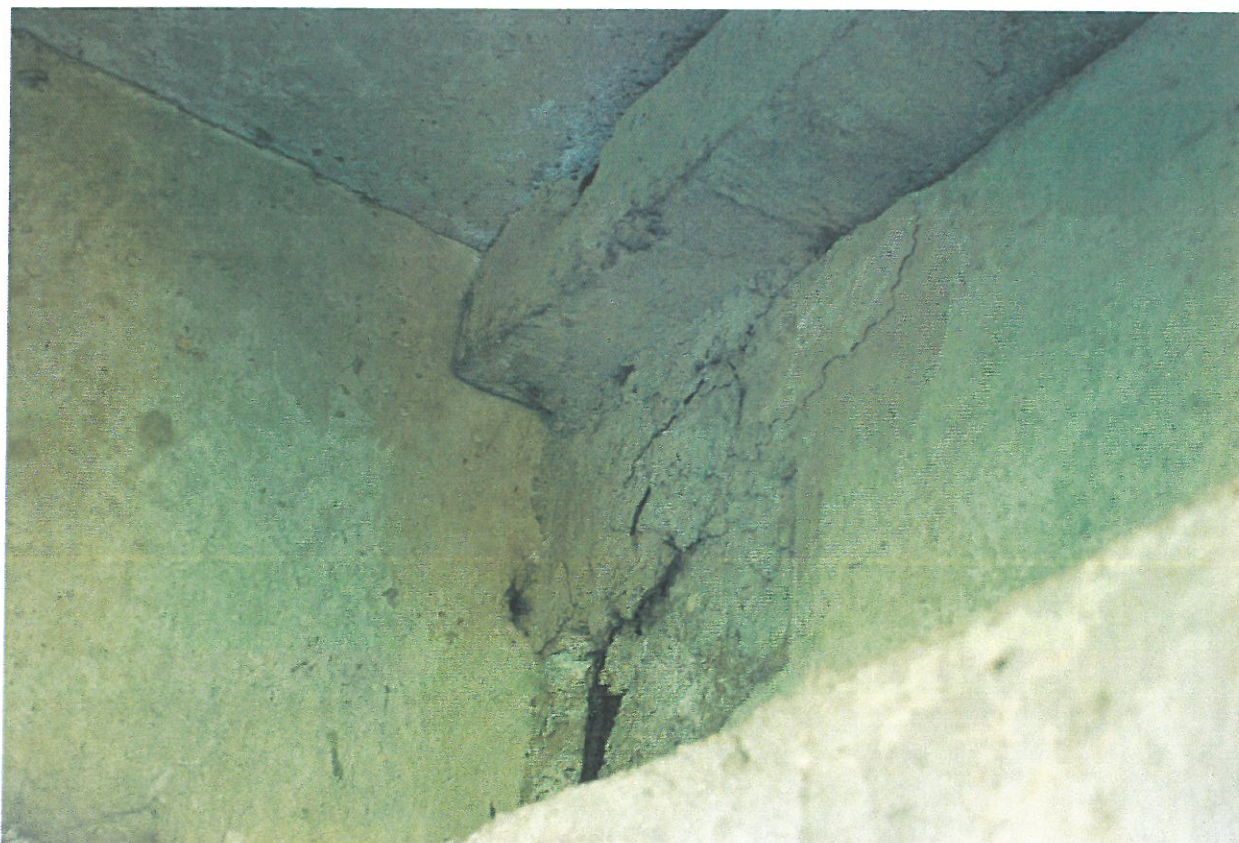
Fot. 20. Degradacja połączeń poprzecznic z dźwigarem.
