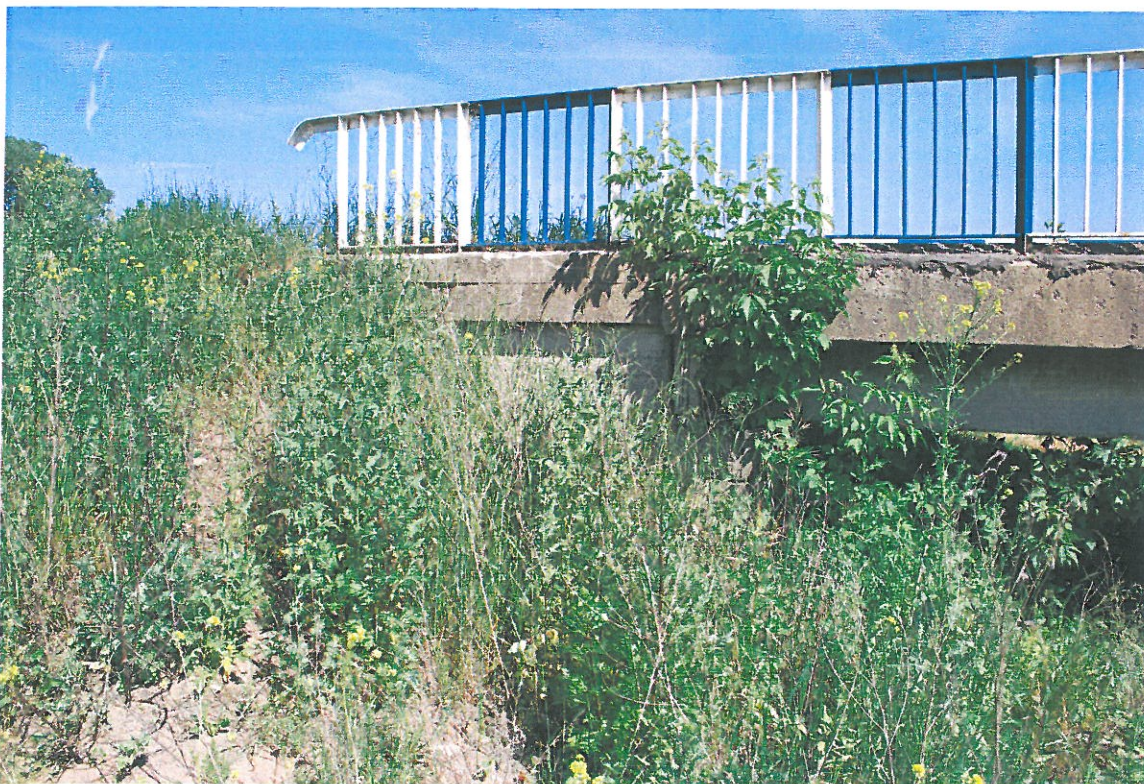
Fot. 6. Wegetacja roślin, zanieczyszczenia ubytki kamienia stożka spowodowane brakiem systematycznych prac utrzymaniowych (stożek od strony północnej – widok od strony dolnej wody)
