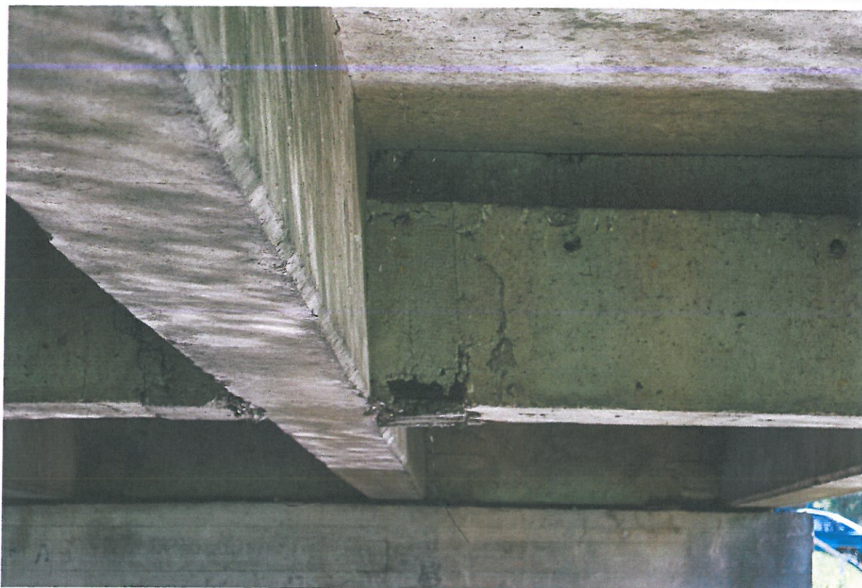
Fot. 21. Ubytki betonu, korozja betonu, korozja odsłoniętych prętów zbrojeniowych poprzecznic.
