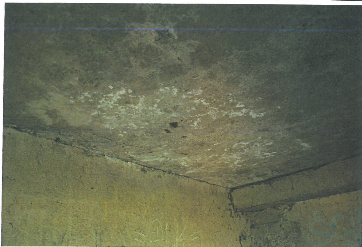
Fot. 15. Osady i wykwity na płycie pomostu świadczące o braku skuteczności izolacji.
