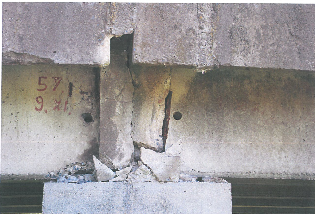
Fot. 18. Degradacja prefabrykowanej poprzecznicy podporowej.
