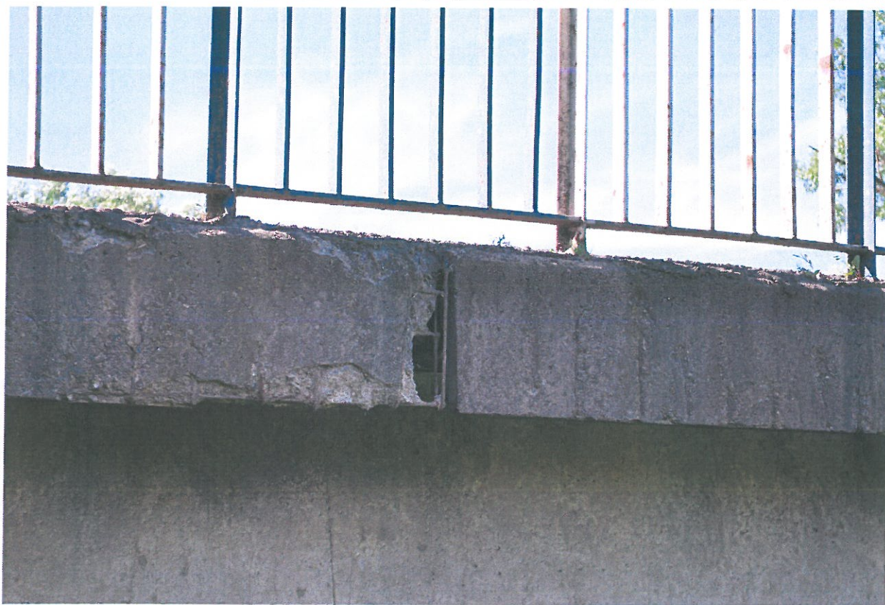
Fot. 13. Ubytki betonu i korozja stali zbrojeniowej prefabrykowanego gzymsu (kapy chodnikowej).
