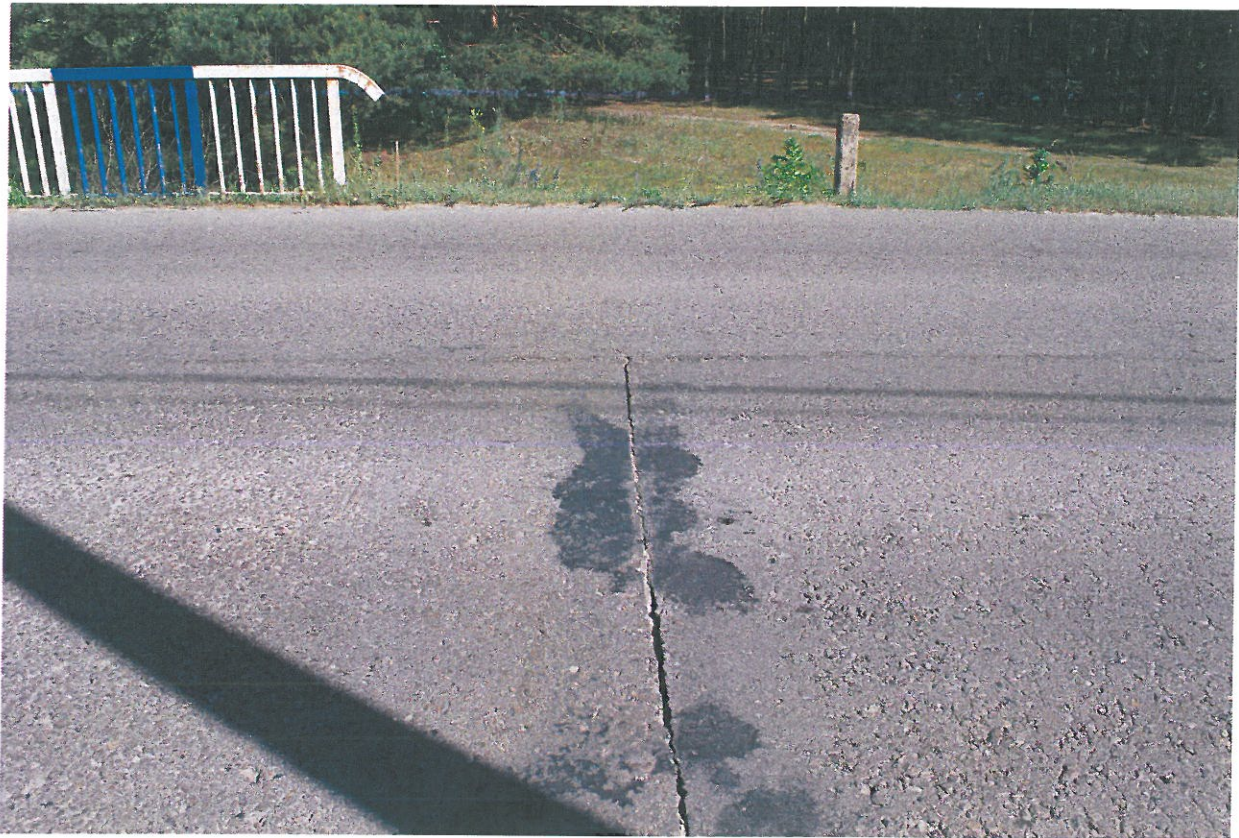
Fot. 7. Ubytki i wykruszenia nawierzchni jezdni w obrębie skrzydeł od strony południowej - widok od strony dolnej wody.
