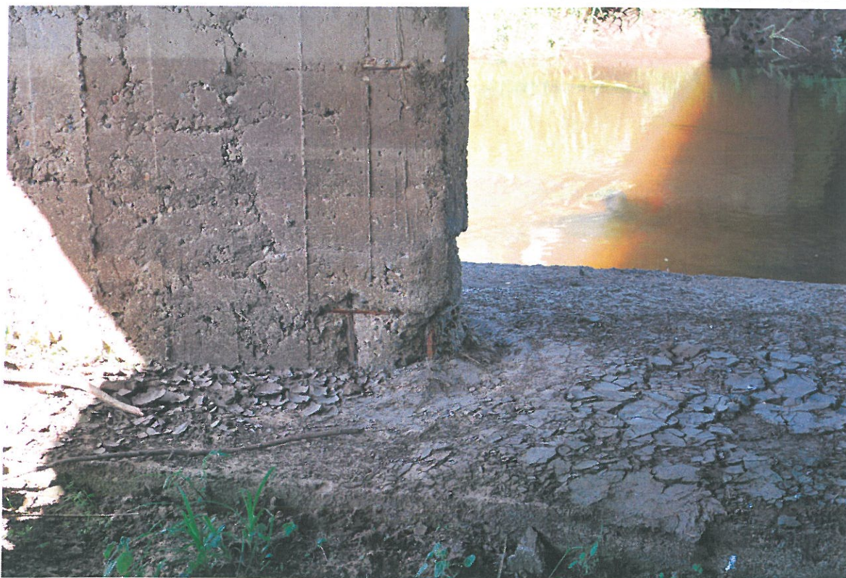
Fot. 24. Ubytki betonu, korozja betonu, korozja odsłoniętych prętów zbrojeniowych filara podpory nr 1.
